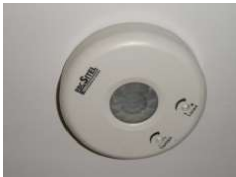
Figura 27. Sensor de movimiento en sanitarios
